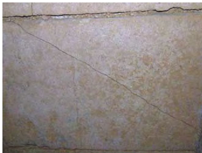
Fig. 20 - Dettaglio delle lesioni nel soffitto del dromos indicato nel rilievo topografico con il n. 5 (foto R. Varriale).
