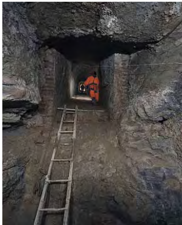
Fig. 19 - La scala operai vista dall'ambiente di crollo alla base (foto G. Belvederi). Fig. 19 - The collapse of the staircase (photo G. Belvederi).
