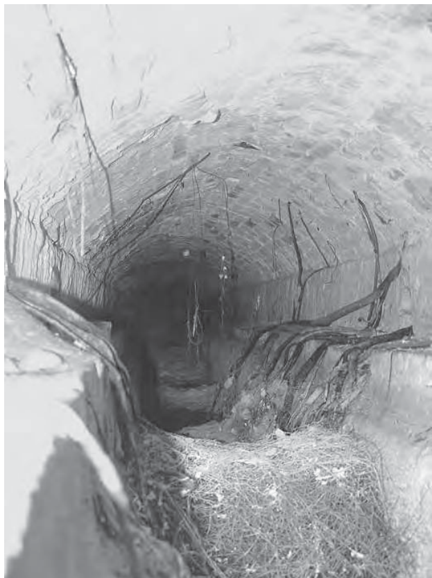
Fig. 34 - Fonte Brecciola, cunicolo interno con infiltrazioni di radici (foto A. De Ascentiis).
