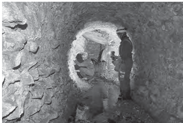
Fig. 9 - Cunicolo emissario di Pantano Secco. Tubazioni in calcestruzzo in prossimità dell'incile (foto C. Germani).
