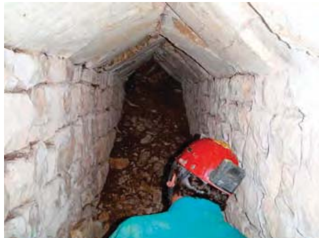
Fig. 18 - Assisi, acquedotto del Sanguinone. Tratto crollato. Fig. 18 - Assisi, the aqueduct of Sanguinone. Collapsed sector.
