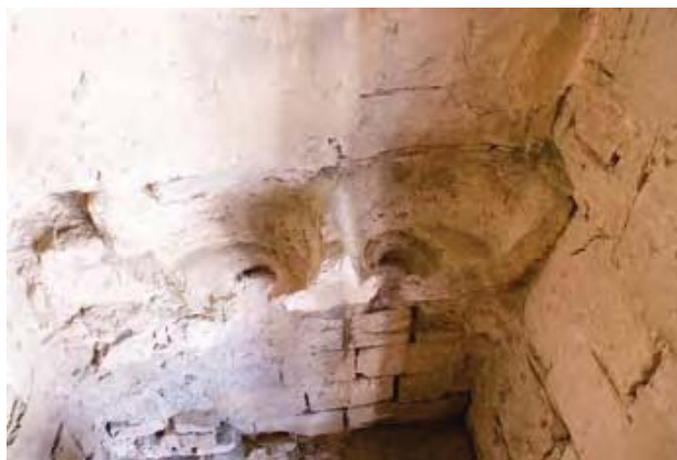
Fig. 5 - Todi, Chiostro S. Fortunato. Le vaschette di raccolta. Fig. 5 - Todi, S. Fortunato cloister. The collection trays.
