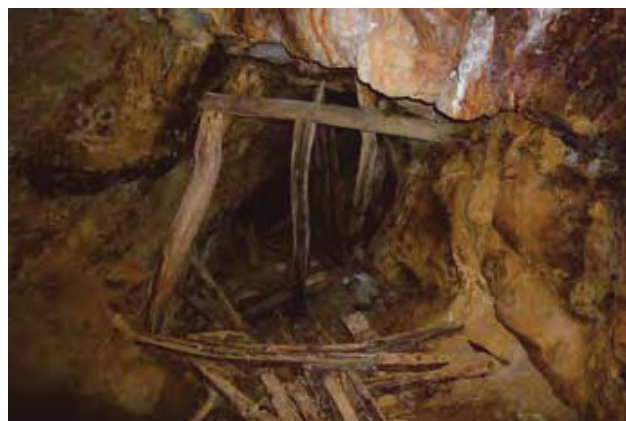
Fig. 3 - Quadri di legno crollati. Fig. 3 - Collapsed wood reinforcements.
