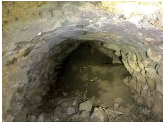
Fig. 9 – Tratto dello speco del Marcio nei pressi del Punto B, visto in direzione nord. Si noti la copertura a spioventi (foto A. Schatzmann).
