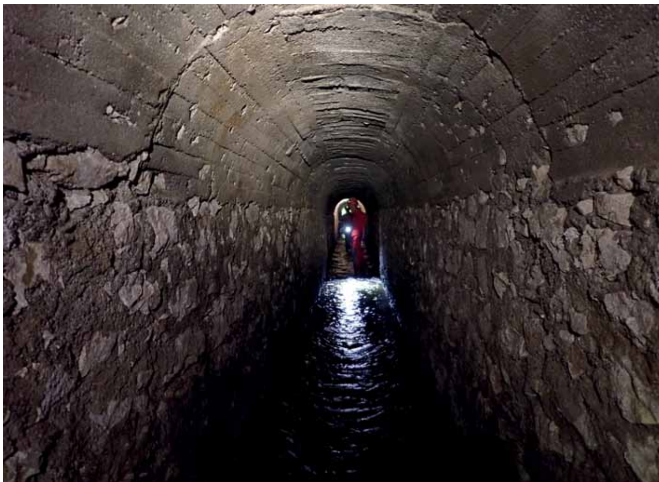
Fig. 5 – Il Traforo verso l'uscita, nella parte più integra, maggio 1923 (foto S. Gambari).
