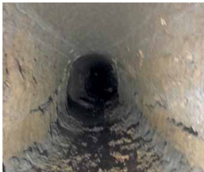
Fig. 22 – Vista del breve e rettilineo cunicolo bypass dal fondo del pozzo P2, scavato parallelo alla galleria di carriaggio di Colle Selva (Galliciano nel Lazio - Roma).
