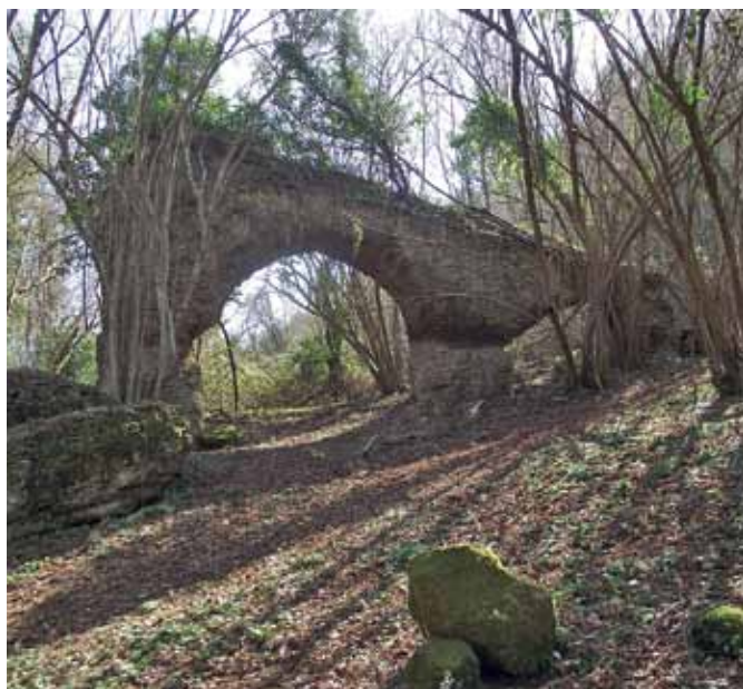
Fig. 10 – Vista dei resti disposti fortemente inclinati delle ultime arcate continue, parzialmente crollate, del Ponte della Mola dell'acquedotto dell' Anio Vetus . Questa parte del ponte bypass permetteva il raccordo con il condotto ipogeo sito sulla riva sinistra della fascia collinare della Tenuta di San Giovanni in Campo Orazio (San Gregorio da Sassola - Roma).
