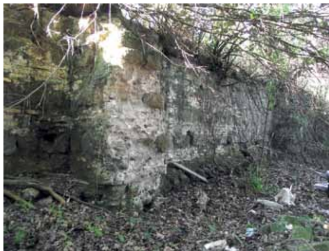
Fig. 26 – Vista del lungo muro di sostruzione dell'acquedotto dell' Anio Novus , sito in località Val Pantano, nei pressi del casolare denominato "Fienile", in prossimità dell'antico tracciato della Via Prenestina (Galliciano nel Lazio - Roma).
