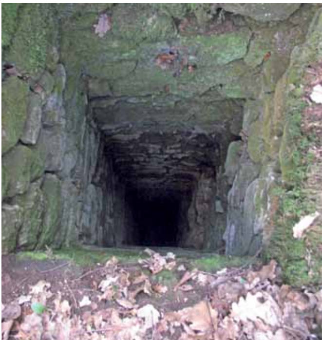
Fig. 15 – Vista dei resti del pozzo P7; le pareti sono realizzate in opera incerta con blocchi di tufo alti cm 15/20 e lunghi cm 20/30; la sua profondità è di oltre m 9.
