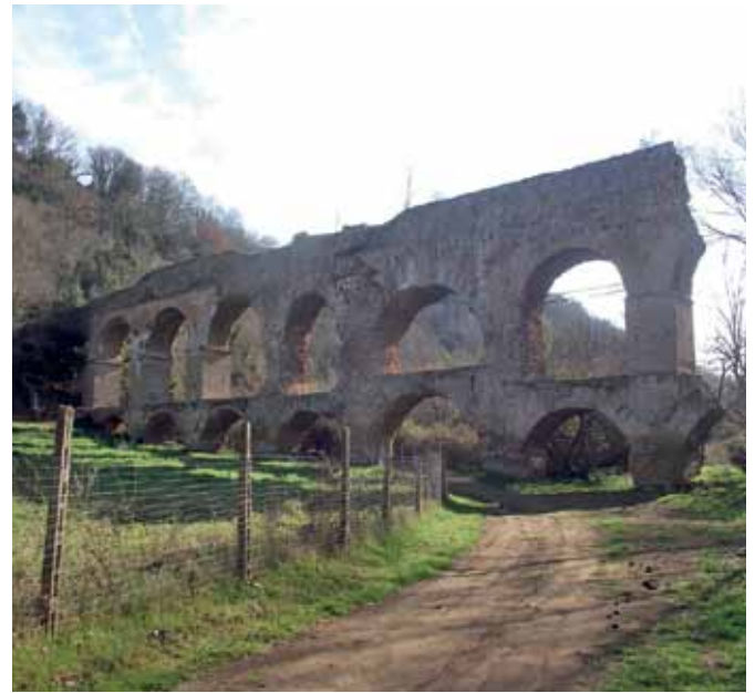
Fig. 6 – Vista dei resti delle arcate continue del Ponte della Mola con la parte centrale crollata all'interno del fosso omonimo nel 1965. Il ponte-canale dell'Anio Vetus, edificato in opera mista d'età adrianea, fu realizzato per bypassare la lunga ansa del condotto ipogeo estesa per oltre un chilometro e mezzo più a monte; San Gregorio da Sassola - Roma.
