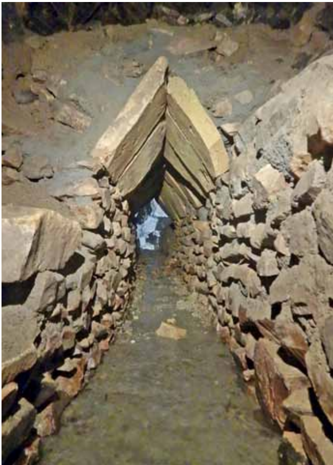
Fig. 13 – Buso della Casara: condotto voltato “alla cappuccina” lungo il collettore principale (settore orientale). Le tavelle in cotto e parte della struttura laterale appaiono consolidate in tempi recenti (foto D. Davolio).
