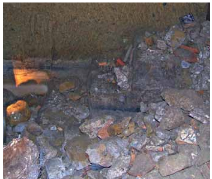
Fig. 4 – Cavità di vicolo San Nicola a Nilo. Scala scavata nel tufo e utilizzata dai pozzari fino al 1885 per l'ispezione della cisterna n° 2 (foto R. Varriale). Fig. 4 – Underground cavity at San Nicola a Nilo alley. Ladder carved along the wall of the cistern No. 2 and used for the inspection of the cavity until 1885 (photo R. Varriale).
