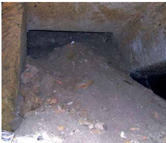
Fig. 3 – Cavità di vicolo San Nicola a Nilo. Pozzo di accesso alla cisterna n° 2 (foto R. Varriale). Fig. 3 – Underground cavity at San Nicola a Nilo alley. Access-shaft to the cistern No. 2 (photo R. Varriale).
